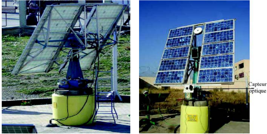
Fig. 5: Vue du dispositif de poursuite sur le site avec positionnement du capteur optique et des pyranomètres
