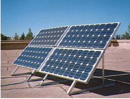
Fig. 3: Modules photovoltaïques SP75 installés à la Faculté des Sciences d'Oujda
