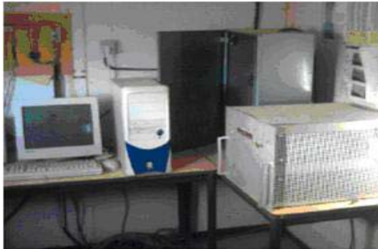
Fig. 2: Vue de la partie électrique
