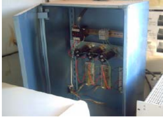
Fig. 8: Armoire de puissance
